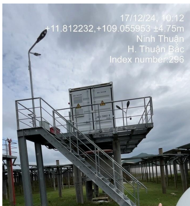
Hình 3.15: Bể thu dầu trạm Inverter
