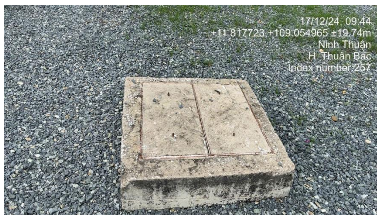
Hình 3.14: Bể thu dầu sự cố trạm biến áp
