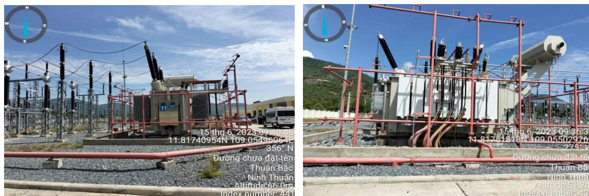
Hình 1.10: Khu bố trí trạm biến áp của dự án
